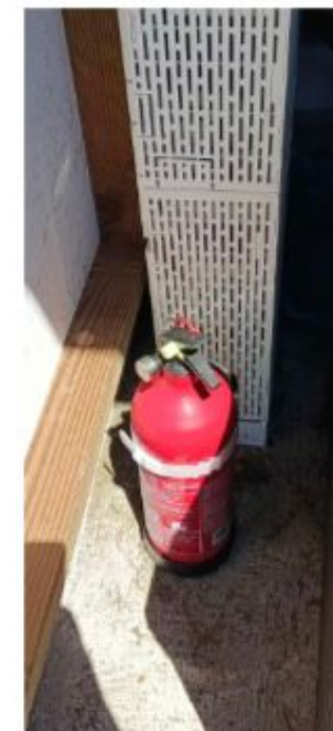
EXTINCTEUR LOCAL ELECTRIQUE
